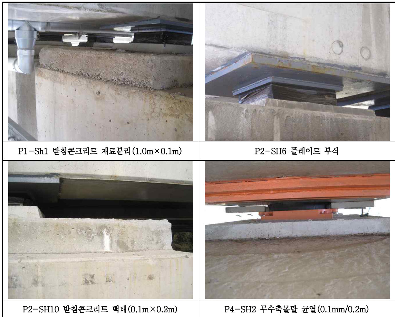
【사진 12.3.36】 교량받침 손상현황
