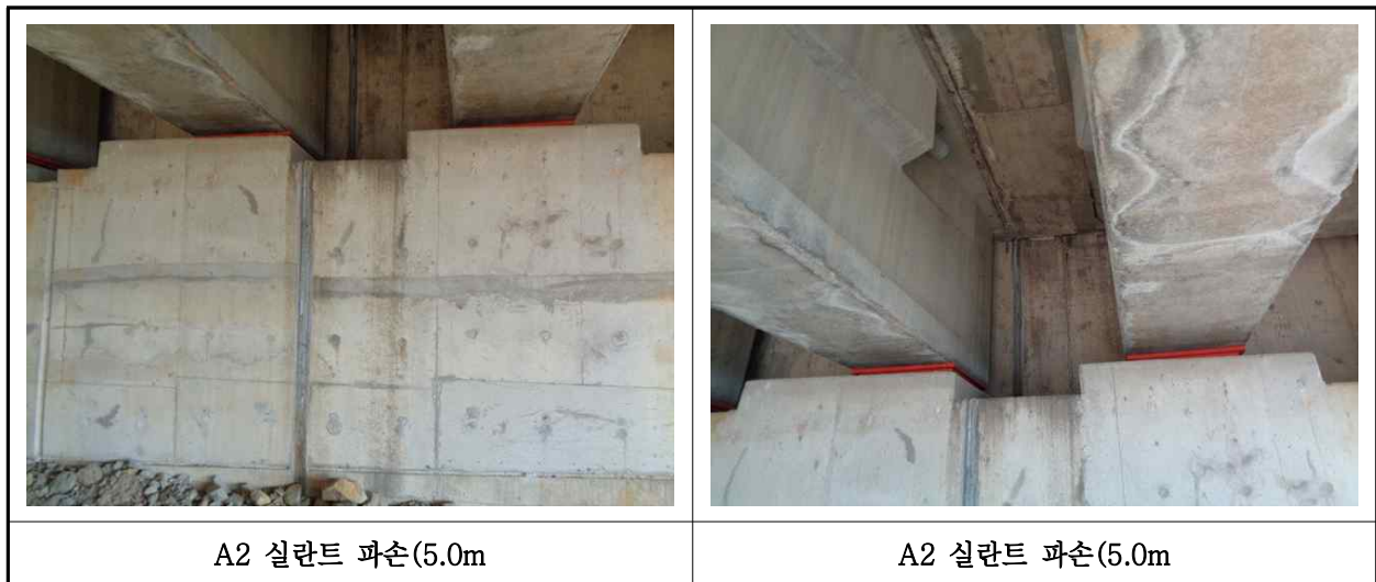
【사진 12.3.32】 교대 손상현황
