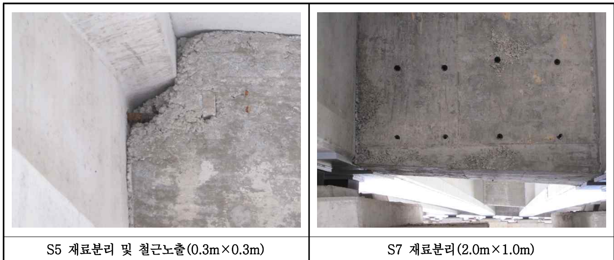
【사진 12.3.7】 가로보 손상현황
